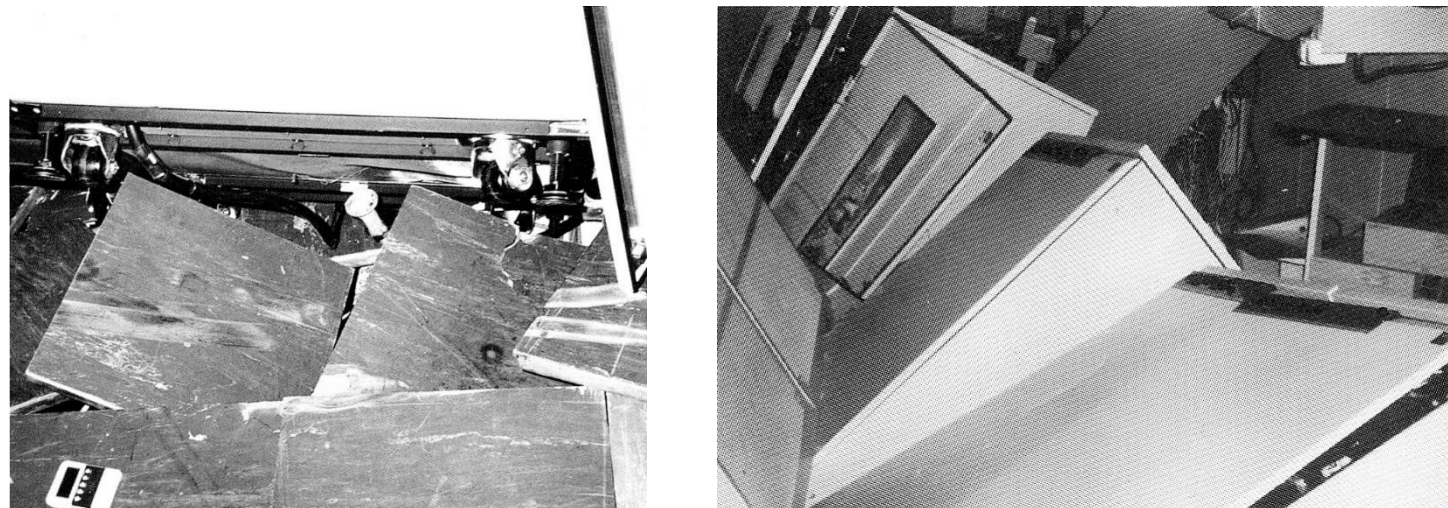
図3.22 フリーアクセスフロアの床パネルの外れ 15) 図3.23 フリーアクセスフロア被害による機器の転倒 15) ・・・阪神・淡路大震災調査報告編集委員会「阪神・淡路大震災調査報告 建築編-6 火災 情報システム」日本建築学会;1998年
